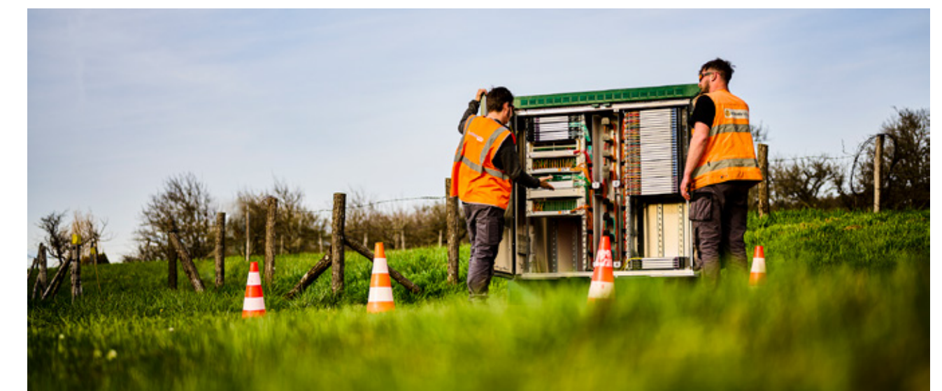
Projet Spinnaker, réseau de fibre optique Infrastructures | Europe | Partenaire : Arjun
